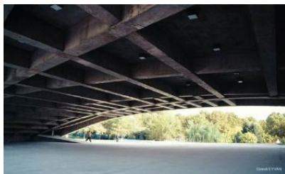
تصاویر ۲ و ۳- پردیس سینمایی ملت، عبور موج انفجار از فضای زیرین ساختمان مأخذ: آرشیو شخصی
